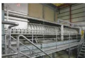
(脱水処理施設)
