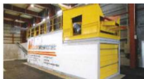
(造粒固化処理施設)
